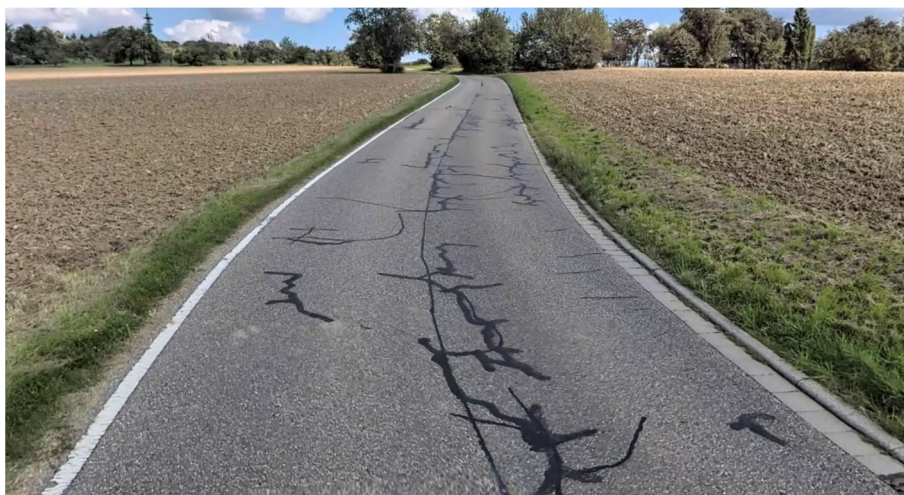
Bild 4: Zustand der Fahrbahn Nußbaumstraße (Blickrichtung Nord-Ost)
